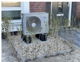
une pompe à chaleur
